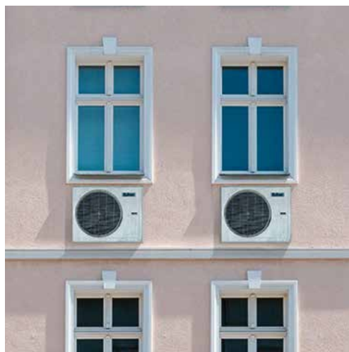
Facciata con unità esterne tradizionali
