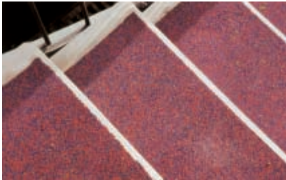
Rutschfester beheizter Epoxidharzbelag auf einer freitragenden Treppe.
