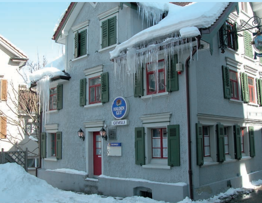
Abb. 1: Eiszapfen können verheerende Gebäudeschäden verursachen und Personen gefährden.
