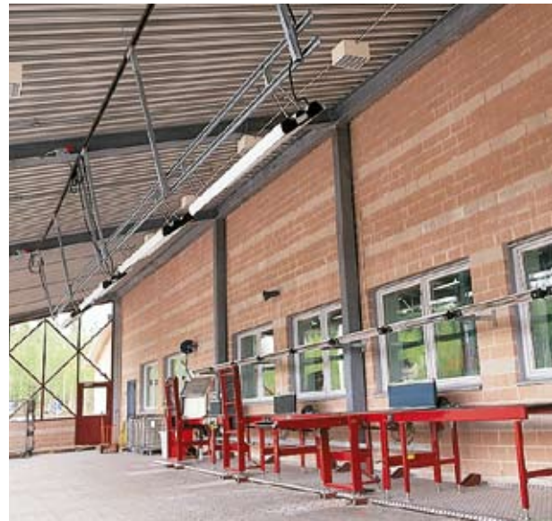
Der IR-Wärmestrahler kann in unterschiedlichen Winkeln montiert werden, um die Wärme dorthin zu richten, wo sie benötigt wird. Außenheizungen sollten unter dem Dach platziert werden. Bei dieser Installation werden die Arbeitsplätze von IR-Wärmestrahlern unter der Decke und CIR-Heizungen an der Wand beheizt.
